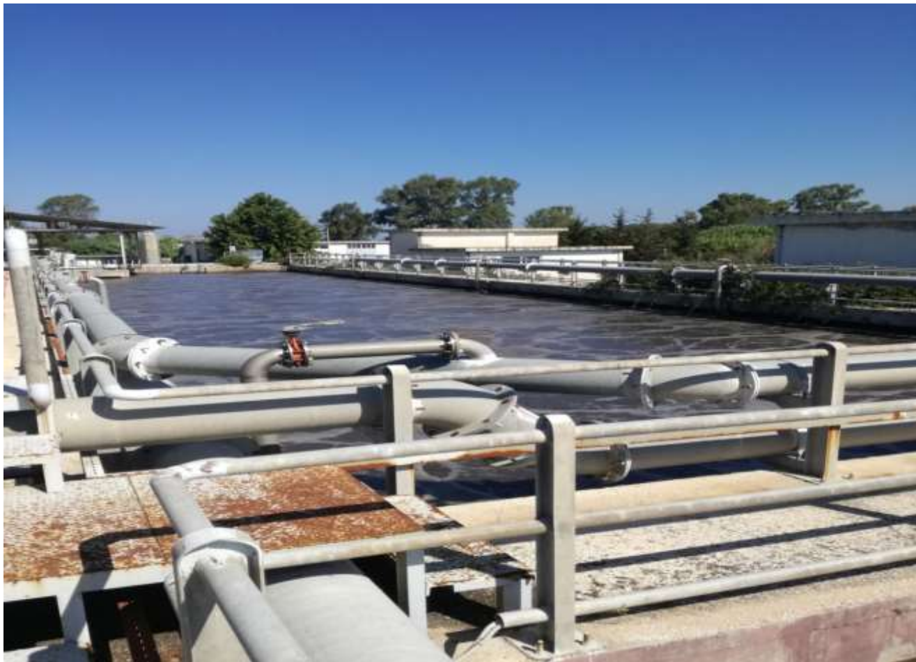
Εικόνα 6 - Εγκαταστάσεις βιολογικού καθαρισμού Δήμου Πρέβεζας
