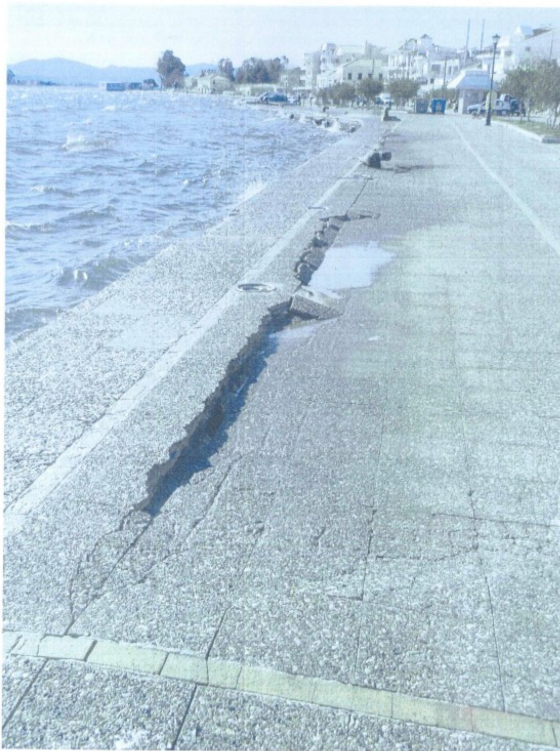
Φωτ. 4: Καθίζηση ανωδομής παραλιακών κρηπιδωμάτων Πρέβεζας. Κυματισμός μικρού ύψους υπερπηδά το κρηπίδωμα, με αποτέλεσμα το θαλάσσιο νερό να λιμνάζει και στη συνέχεια να διηθείται πίσω από το μέτωπο.
