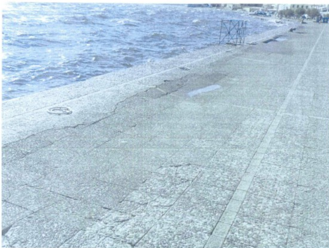
Φωτ. 5: Ευρύτερη περιοχή καθίζησης ανωδομής παραλιακού κρηπιδώματος
